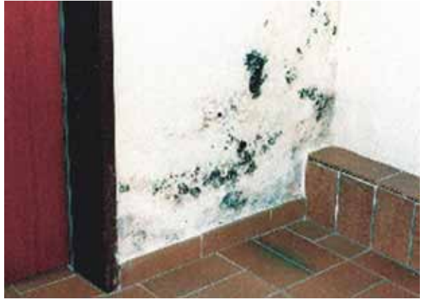
Şekil 3 : Duvar üzerinde oluşan küflenmeler.
